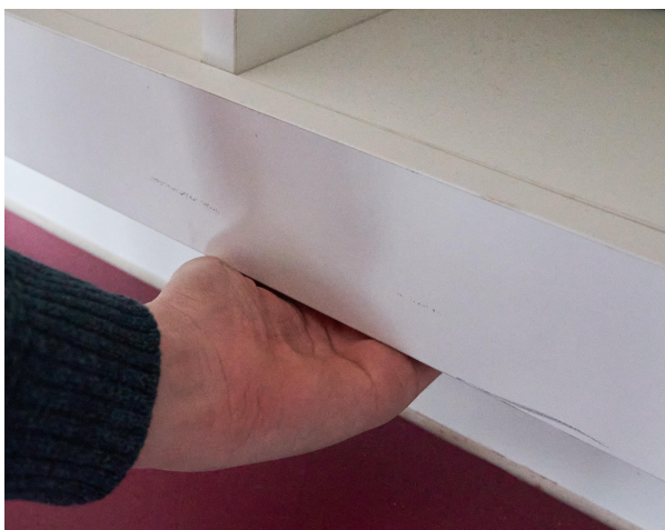
Figure 29 (Quelle: Passivhaus Institut Darmstadt) Luftauslass in der Albrecht-Dürer-Schule in Weiterstadt
